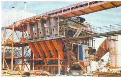
Figura 1. Generador de Vapor que usa Bagazo Tipico.
