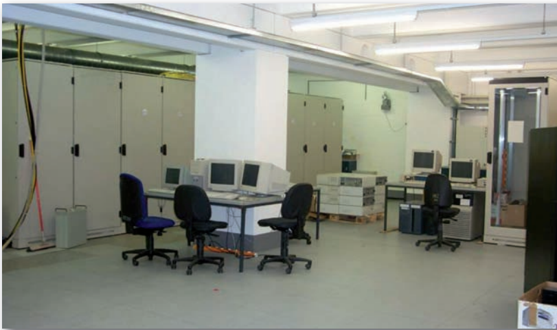
Fig. 2.25. Vista de las canalizaciones en la instalación inicial de un centro de proceso de datos.
