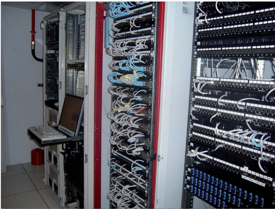
Fig. 2.23. Vista de un cuarto de comunicaciones instalado con cableado estructurado y certificado.
