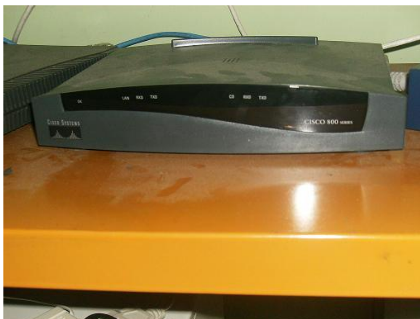
Figura 22: Router para la conexión al exterior.
