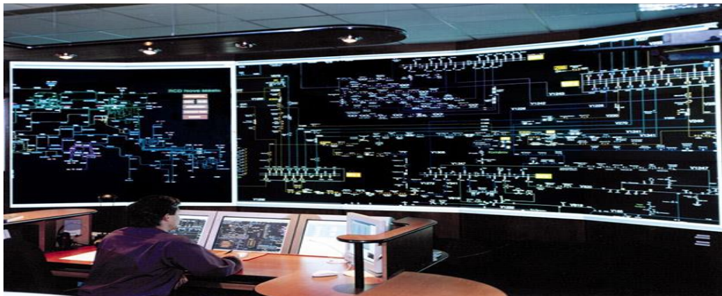
Figura 1: Operador interactuando con la Interfaz Hombre-Máquina de un sistema SCADA.
